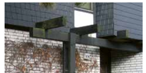
Abb. 5: Diese Holzträger sind weder durch einen Dachüberstand noch durch eine Abdeckung vor der Witterung geschützt. Hier liegt die Gebrauchsklasse GK 3.2 vor. Die Holzfeuchte kann über 30 % betragen. Somit wäre ein Befall mit Holz zerstörenden Pilzen möglich. Es ist eine Holzart mit hoher Dauerhaftigkeit zu verwenden. Geeignet ist das Kernholz der Eiche. Nadelholzarten sind hier nicht zulässig.
