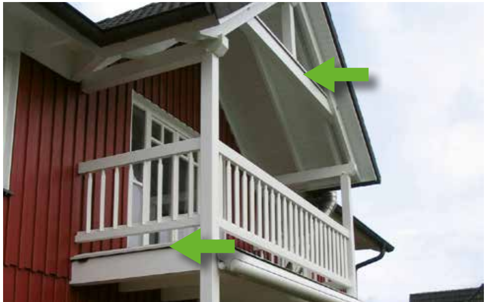
Abb. 8: Die horizontalen Holzträger sind bei diesem Balkon durch eine Metallabdeckung bzw. durch eine Abdichtung mit Abdeckbrettern geschützt.
