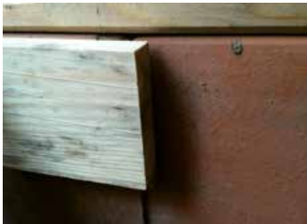
Abb. 2: Das Holz ist trocken und nicht das Problem. Das Symptom Schimmel zeigt sich nur leider oft auf Holz. Ursache ist eine hohe Feuchte im Neubau.
