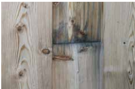
Abb. 7: Stumpfe Stöße sind bei senkrechten Brettbekleidungen (z. B. Holzfassade) nicht zulässig. Diese können Kapillarfenen bilden und zur verstärkten Aufnahme von Wasser über das Hirnholz führen.
