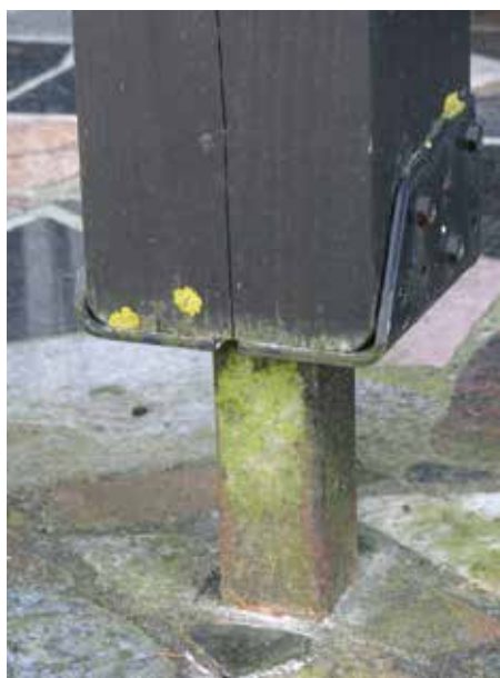
Abb. 9: Der Pfostenträger ragt bei diesem Beispiel sogar über die Kante der Holzstütze hinaus. Niederschlagswasser kann so in großer Menge in die Hirnholzfläche eindringen.
